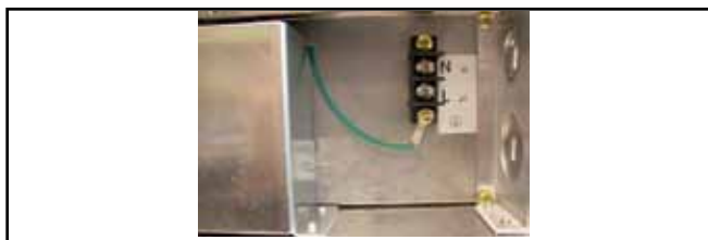
Figura 7. Conexiones del cableado de la caja de derivación
