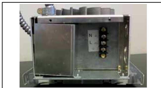
Figura 5. Cubierta de la caja de derivación
